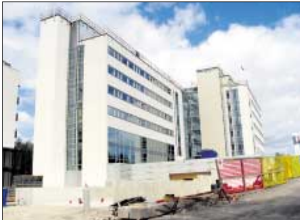
TietoEnatorin kolmas toimistotalo Aku Korhosen tiellä on valmistumassa. Yhtiön toiminnasta ja henkilökunnasta Suomessa on pian merkittävä osa Lassilassa. Kuva KK.
